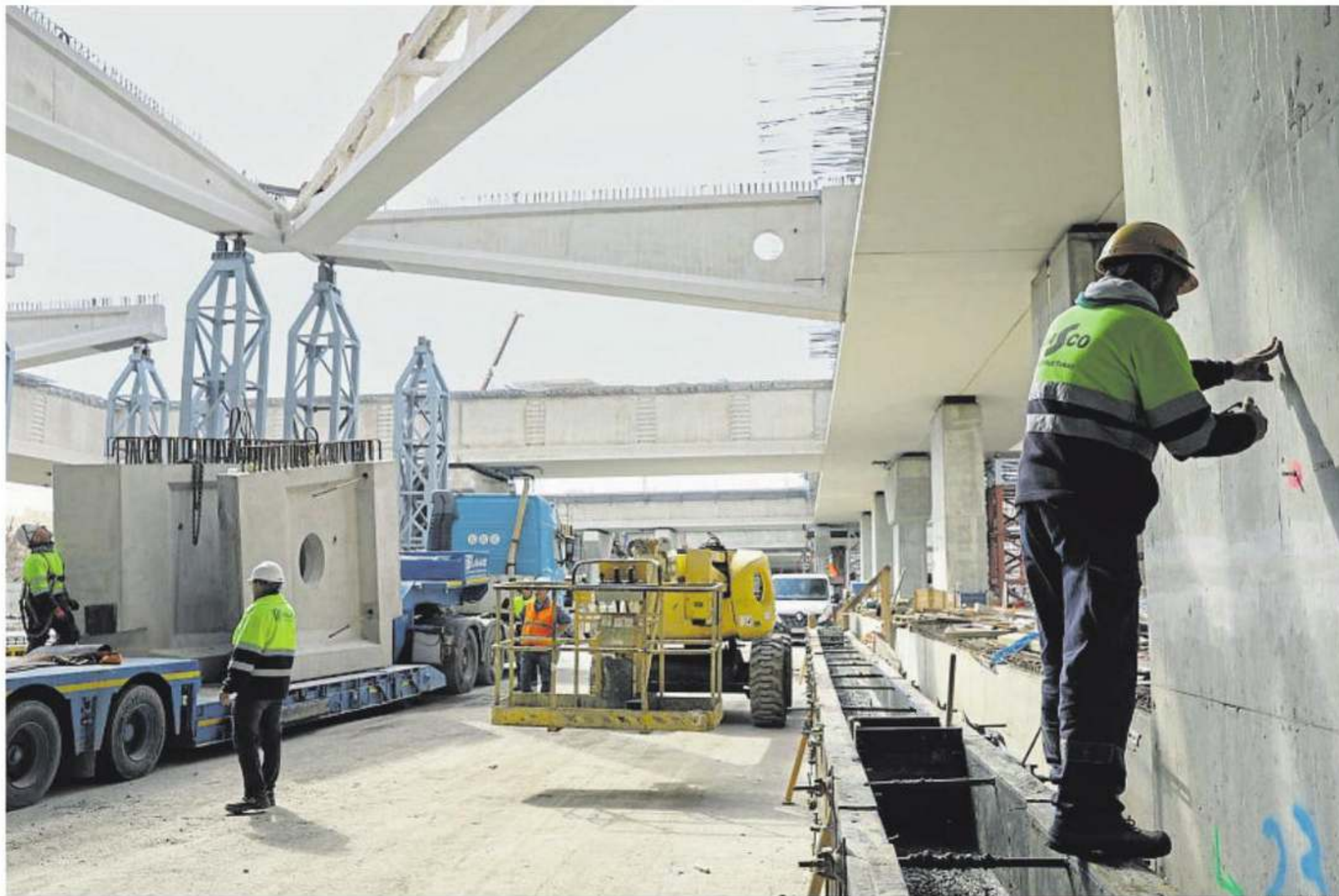
Los operarios trabajan en la construcción de la cubierta bajo las vigas que le darán su peculiar forma
